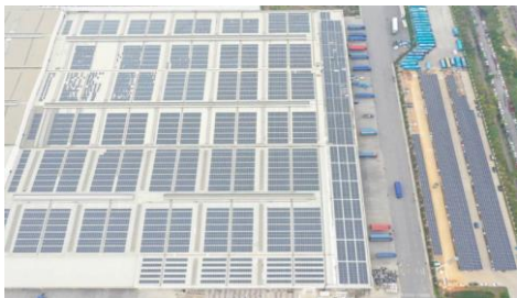
光伏一期航拍
